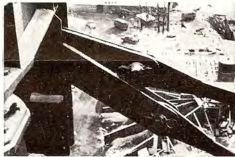
Bild 4: An der Turmspitze befestigte Fangeisen.
